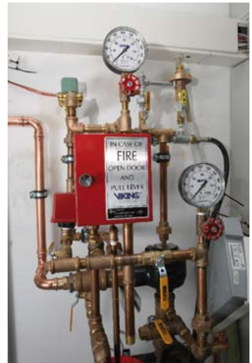
Bild 7: Innovative Brand-Erkennungs- und -bekämpfungsanlage im inHaus1
