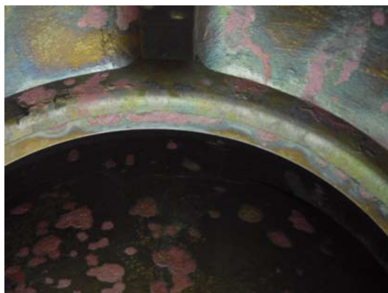
Bild 7: Korrosion infolge von Belüftungselementen an einer Armatur aus einer Kupfer-Aluminium-Legierung (Foto: TKMS)
