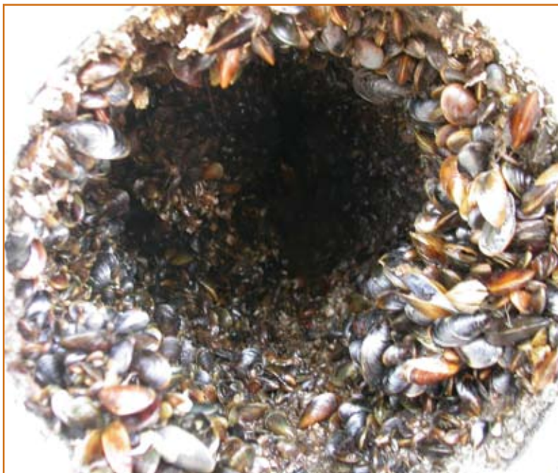
Bild 2: Muschelbewuchs in seewasserführendem Rohr (Foto: TKMS)
