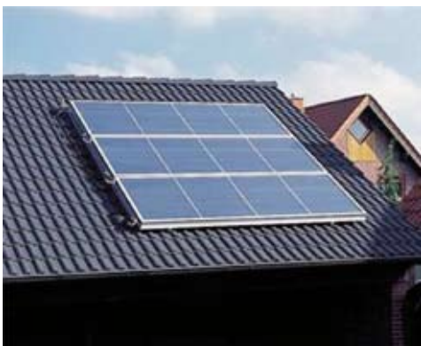
Bild 1: Solarabsorber-Flachpaneel auf Hausdach (ESTIF)
